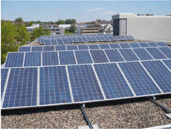
PV-Anlage auf dem Dach des Ludwig-Marum-Gymnasiums
